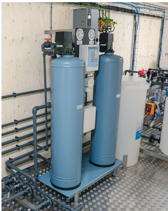
Figur 1: Två kolonner med avhärtningsmassa monterade i container för beredning av vatten inför omvänd osmos.
